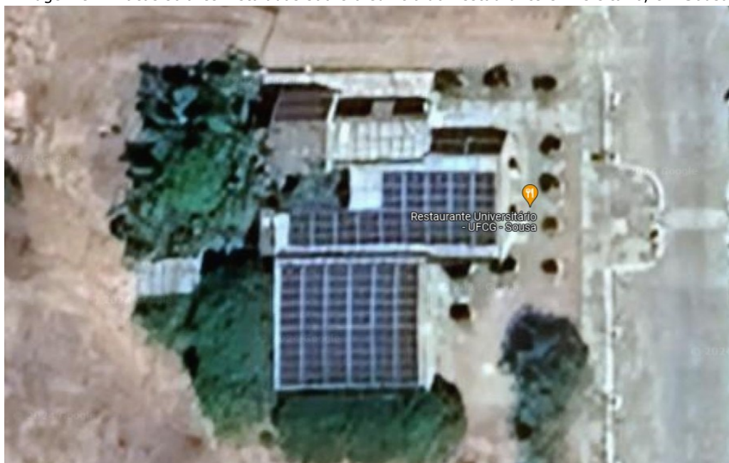
Imagem 9 – Placas solares instaladas sobre o edifício do Restaurante Universitário, em Sousa
