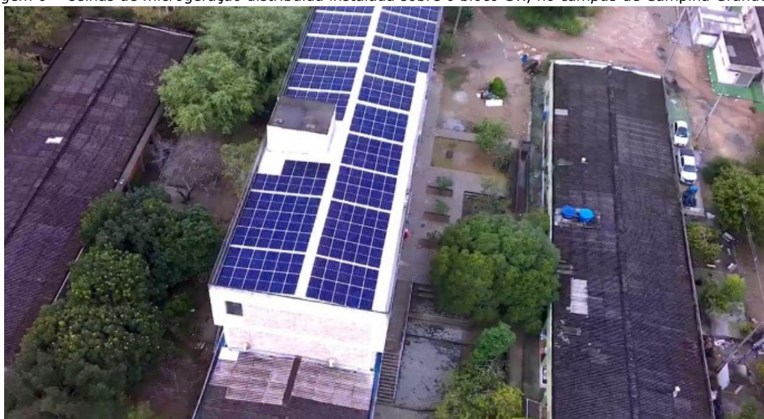
Imagem 6 – Usinas de microgeração distribuída instalada sobre o bloco CW, no campus de Campina Grande
