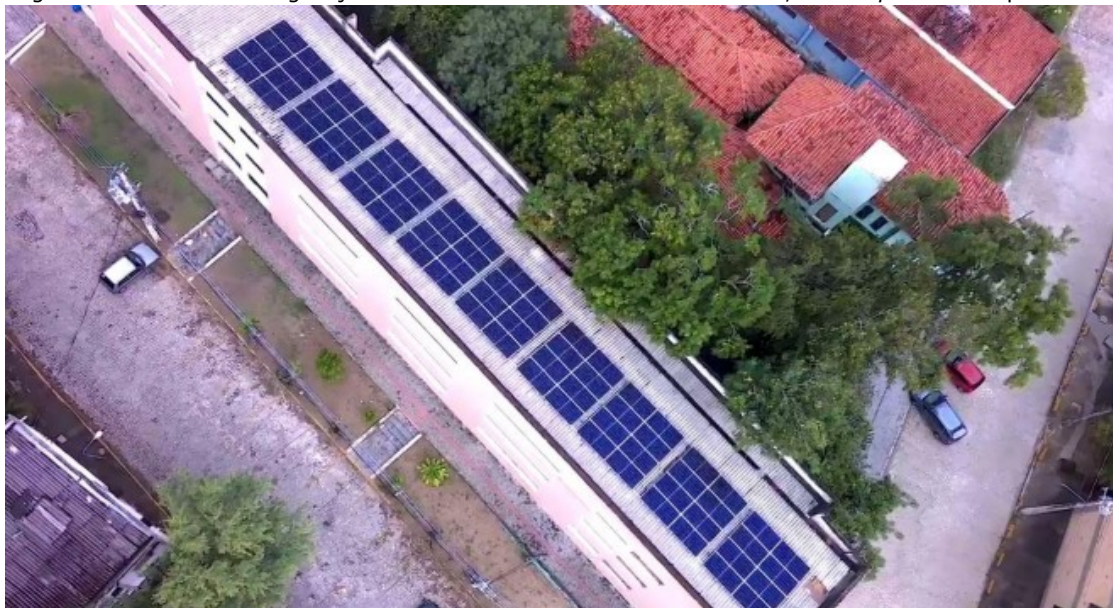
Imagem 5 – Usina de microgeração distribuída instalada sobre o bloco BG, no campus de Campina Grande
