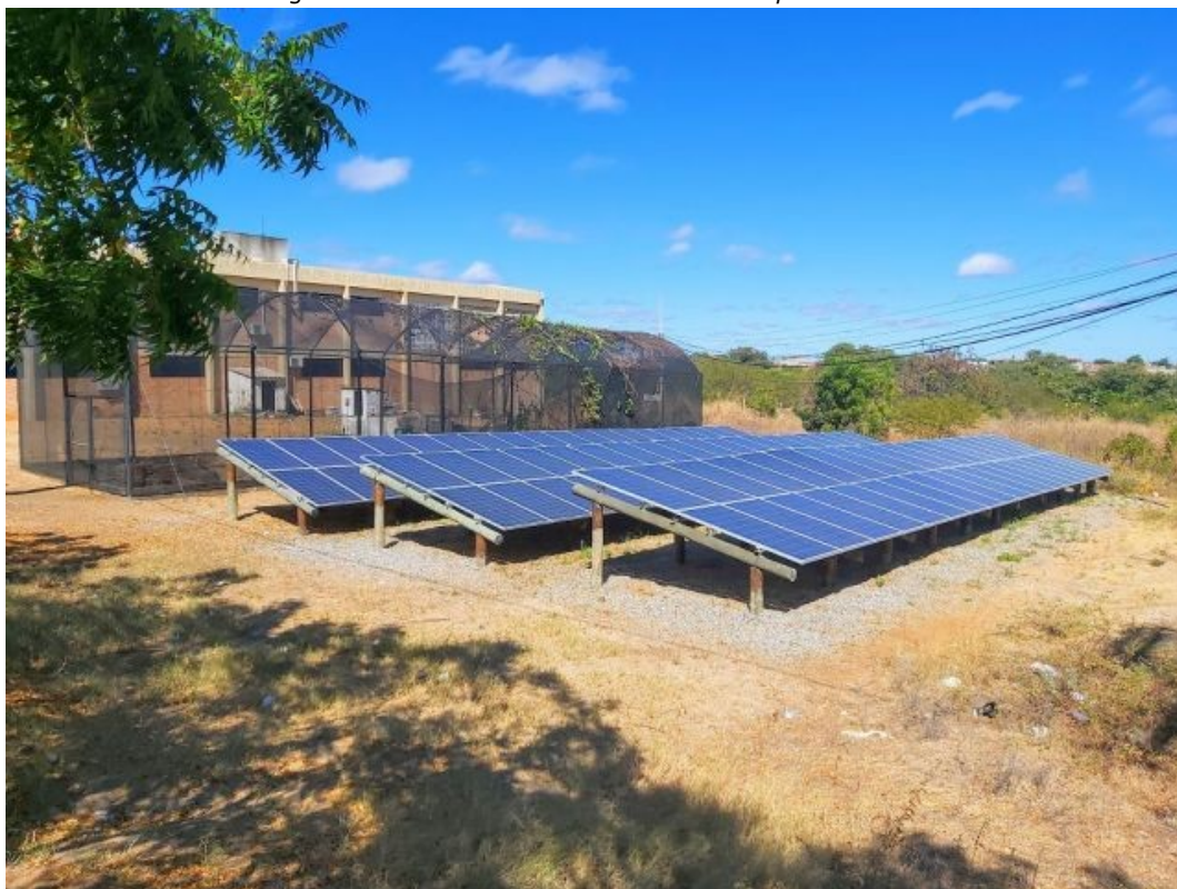
Imagem 1 – Usina Solar Fotovoltaica no campus de Pombal
