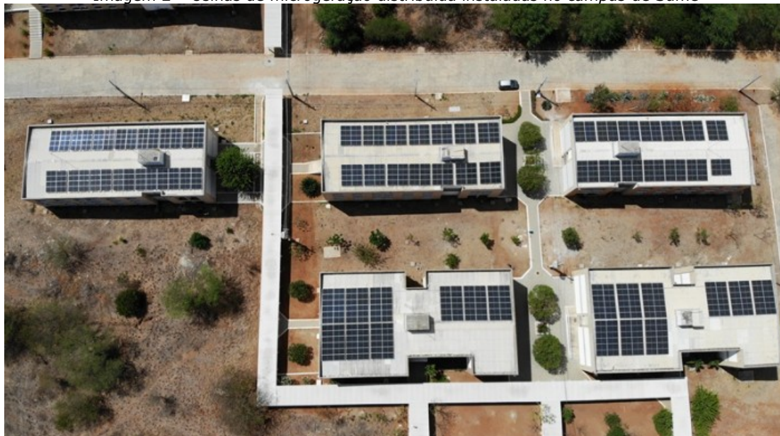
Imagem 2 – Usinas de microgeração distribuída instaladas no campus de Sumé
