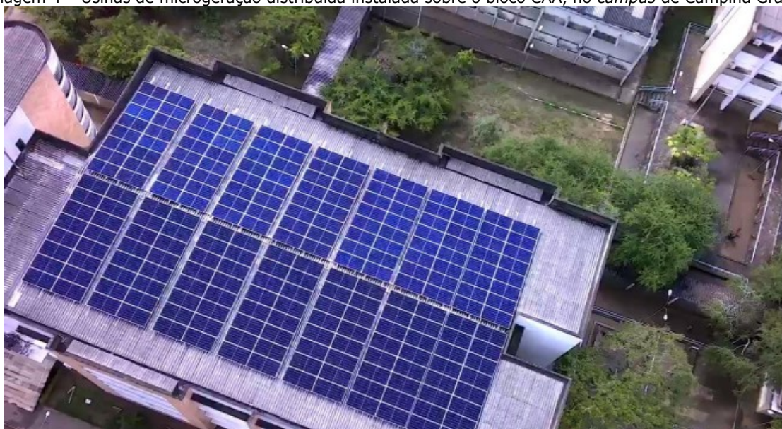
Imagem 4 – Usinas de microgeração distribuída instalada sobre o bloco CAA, no campus de Campina Grande
